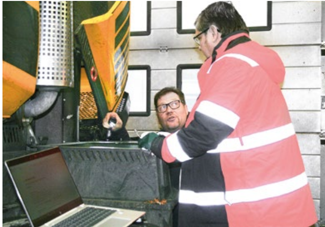
Jarmo Neuvonen (vasemmalla) tarkistaa Metsä-Weljet Oy:n metsätraktorin akkujen päävirtakaapeleita, releitä ja sulakkeita. Antti Ihalainen yrityksestä seuraa. Kuvassa myös tietokone, jonka avulla käytettiin IF:n kehittämää paloturvallisuustyökalua.
