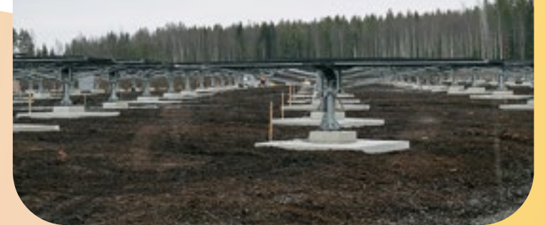
Pienellä osalla Heininevan aurinkovoimalakenttää kennot ovat träkkereitä eli ne seuraavat auringon kulkua päivän mittaan. Valtaosa alueen kennoista on kiinteitä. Kuva: Tapio Hirvikoski
