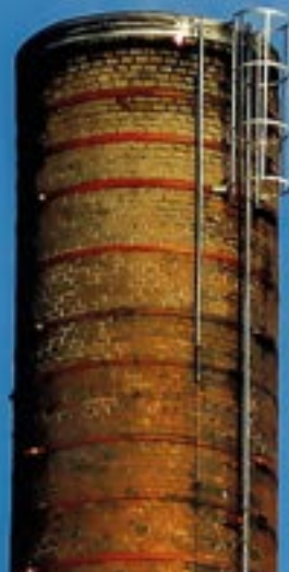
Piippujen tulppaus eli hiilidioksidin talteenotto on noussut nopeasti yhdeksi ilmastopolitiikan kärkipilariksi niin kansainvälisesti kuin kotimaassa. Kuva: Anne Nygård.
